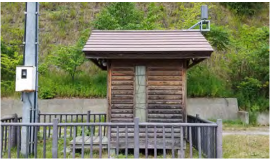
水位・雨量観測データの提供
