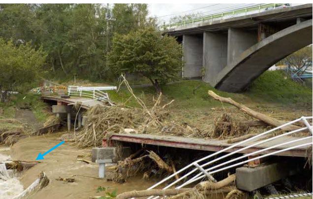
写真 1-9 伊達西小学校近くの人道橋 (平成29年9月出水)
