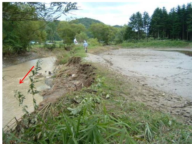
被災状況（豊郷上流地区）H18.8 撮影
