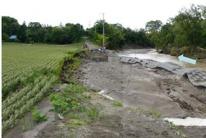
写真-10 農地被災状況(平成18年8月)SP15200付近
