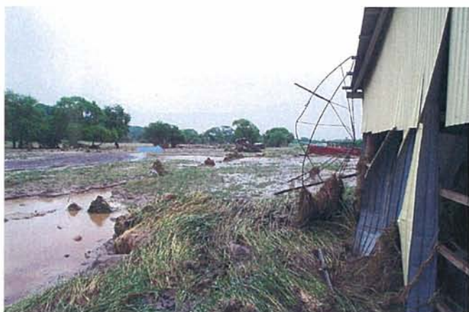
写真-10 農地被災状況(平成15年8月) 国道門別橋上流
