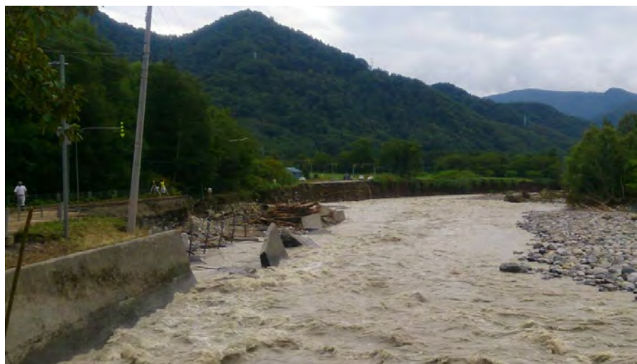
写真-7 平成28年(2016年)8月 台風第10号による被災状況 (千呂露小橋上流 左岸河岸決壊)
