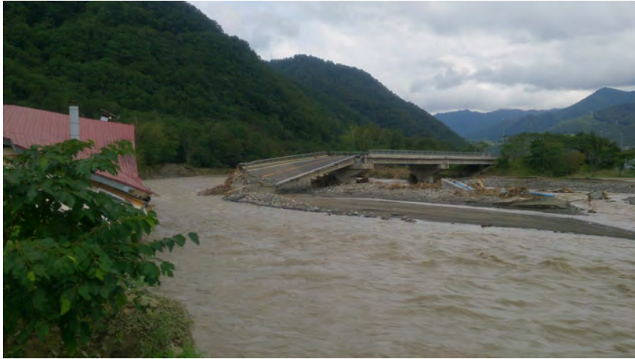
写真-4 平成28年8月 台風10号による被災状況 (千呂露橋 ちるるぼし 付近 住宅半壊, 国道橋被災)
