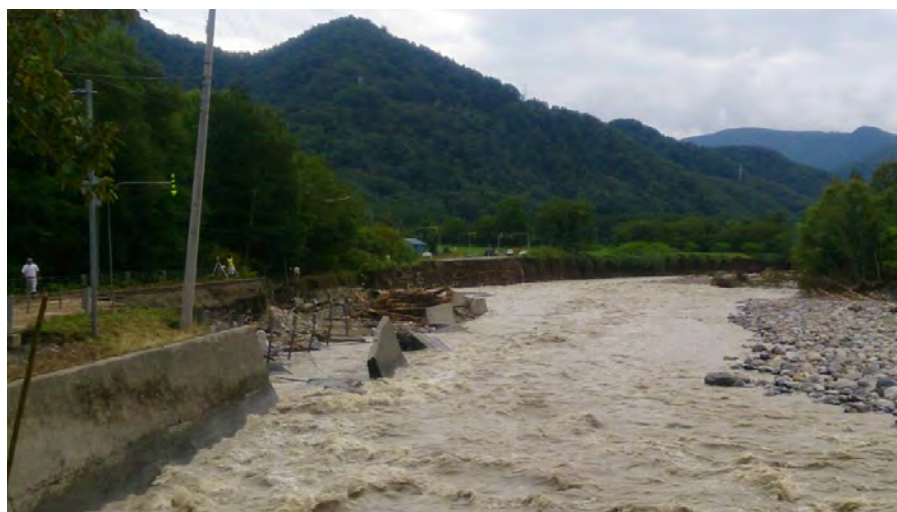
写真-6 平成28年8月 台風10号による被災状況 (千呂露小橋 ちるるこぼし 上流 左岸河岸決壊)
