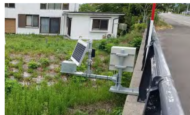
水位・雨量観測データの提供
