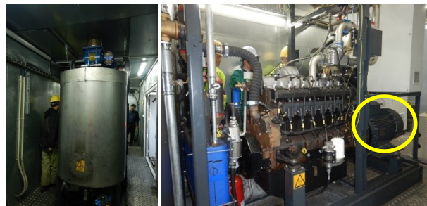
（左）木材チップを加熱分解し、一酸化炭素等を取り出すガス化装置、（右）ガスエンジンと発電機（右下黄色丸枠内の凸部分）
