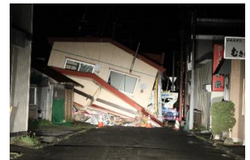
商店街の被害（むかわ町）
